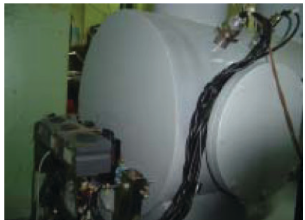
图 3 安装于电缆终端一侧的 FP 测量模块
